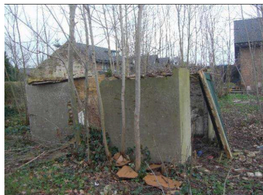
Lijkenhuisje op de begraafplaats, thans verwaarloosd erfgoed.
