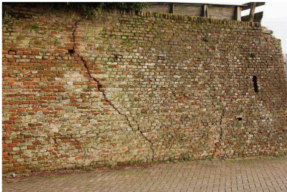
Ernstige scheurvorming stadsmuur Montfoort
