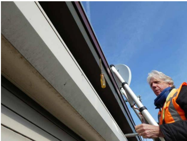
Figuur 10: Inspectie op kieren onder trespas
