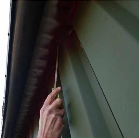
Figuur 14: Geen toegang tot de dakrand
