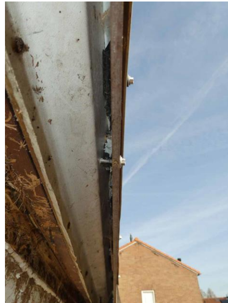
Figuur 17: De kier onder trespas met dakbedekking en isolatiemateriaal
