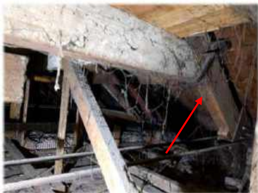
Een kijkje boven het plafond in de zaal. Met diverse trekstangen is de constructie verstevigd. Bij de pijl zijn spijkergaten zichtbaar.
