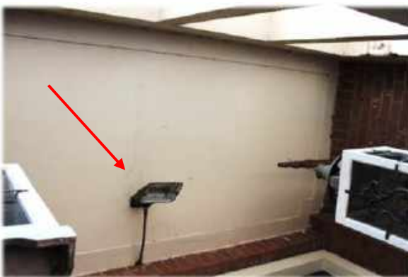
Het stucplafond in het toegangsprotaal. Bij de pijl heeft een aansluiting voor een lamp gezeten.
