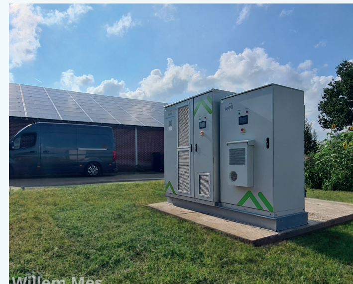
^ Projectbatterij bij zon op dak
