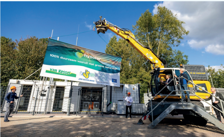
^ Elektrolyser groene waterstof Nieuwegein
