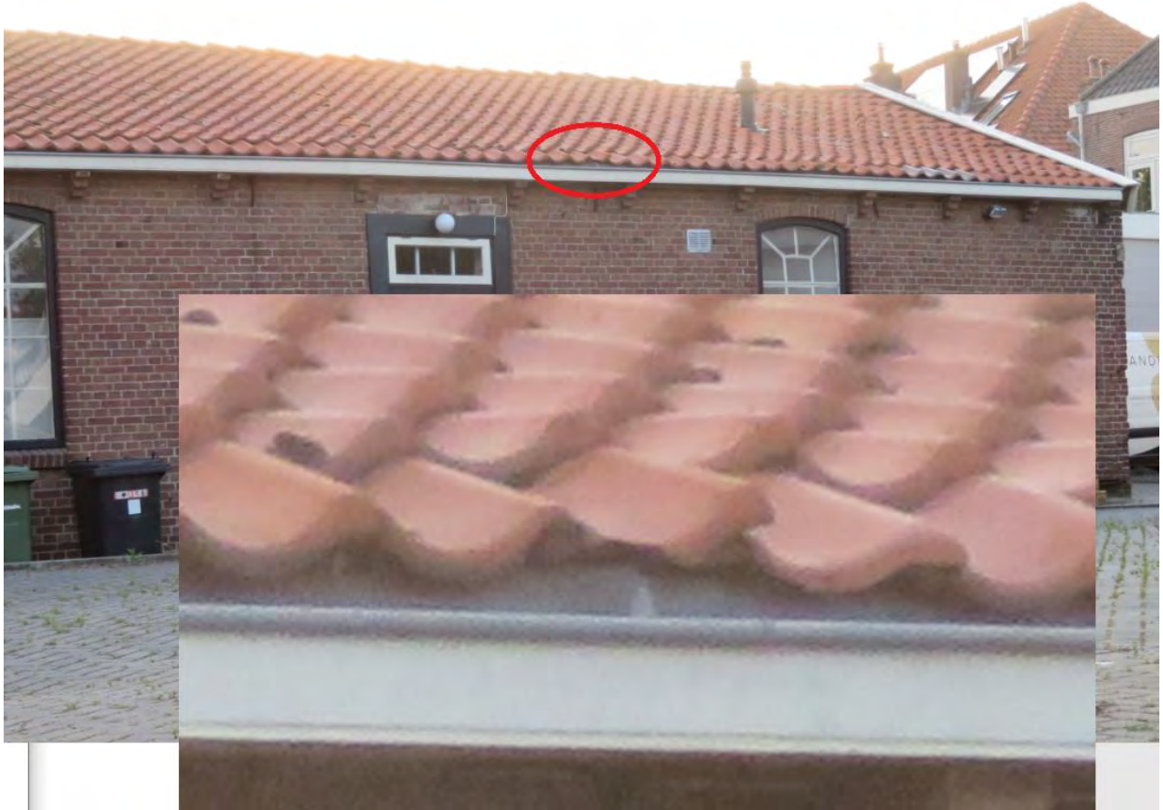
Bij de schuur wijkt 1 pan in de dakgoot iets af van de rest. Op de close-up is te zien dat deze geen toegang tot een achterliggende ruimte geeft. De foto geeft ook aan dat de rest van de dakpannen goed aansluit.
