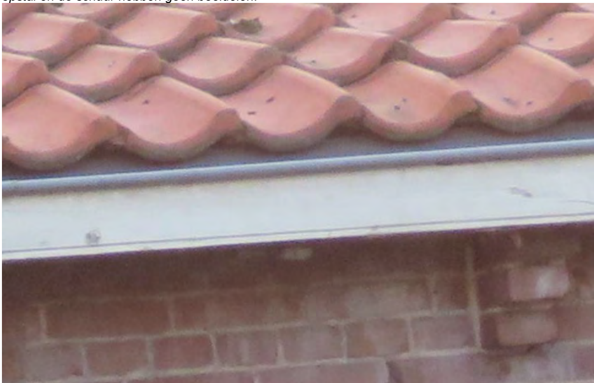
Close-up foto dakpannen en goot schuur. Te zien is dat er geen ruimte is voor huismussen tussen goot en pannen.
