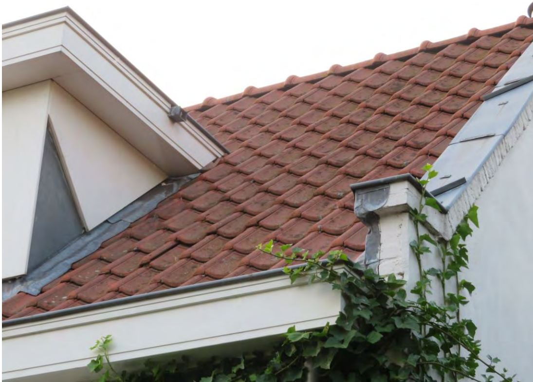
Dakpannen en loodslabben bij dakkapel sluiten goed aan.
