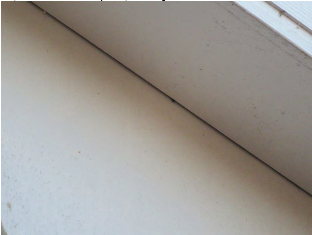
Te kleine ruimte tussen betimmering bij dakkapel (close-up van vorige foto).
