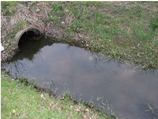
Figuur 1 Een duiker die op lucht ligt. Voor een deel boven de waterlijn voor een betere doorstroming.
